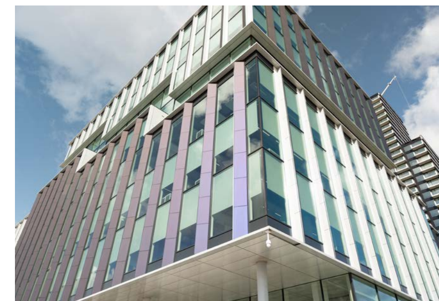
In de vliesgevels zitten enkele opengaande raamdelen, die over het algemeen verborgen zijn achter driehoekige vinnen. Op deze vinnen zijn ventilatieroosters en PV-panelen in drie kleuren aangebracht. (Beeld: MVL Media Groep)
